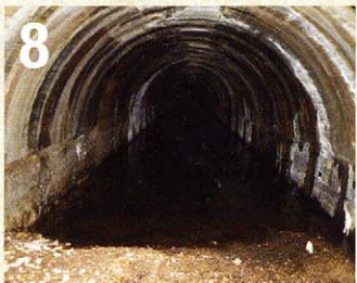
8 秋町隧道南口から覗いた洞内。全長は約300mだが、崩壊のためほとんど北口の光は見えない。しかし、通り抜けが出来ない本当の理由は、水深2mを僅に超える水域が全体に広がっているためだ。
