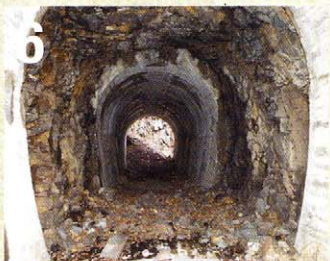
6 六厩川橋のすぐそばに口を開けている小箕谷隧道。秋町隧道と違って通り抜けが可能。なお、洞内は経費削減のためか、あるいは断層帯を緩衝するためか、2ヶ所にわたって素掘のままになっている。
